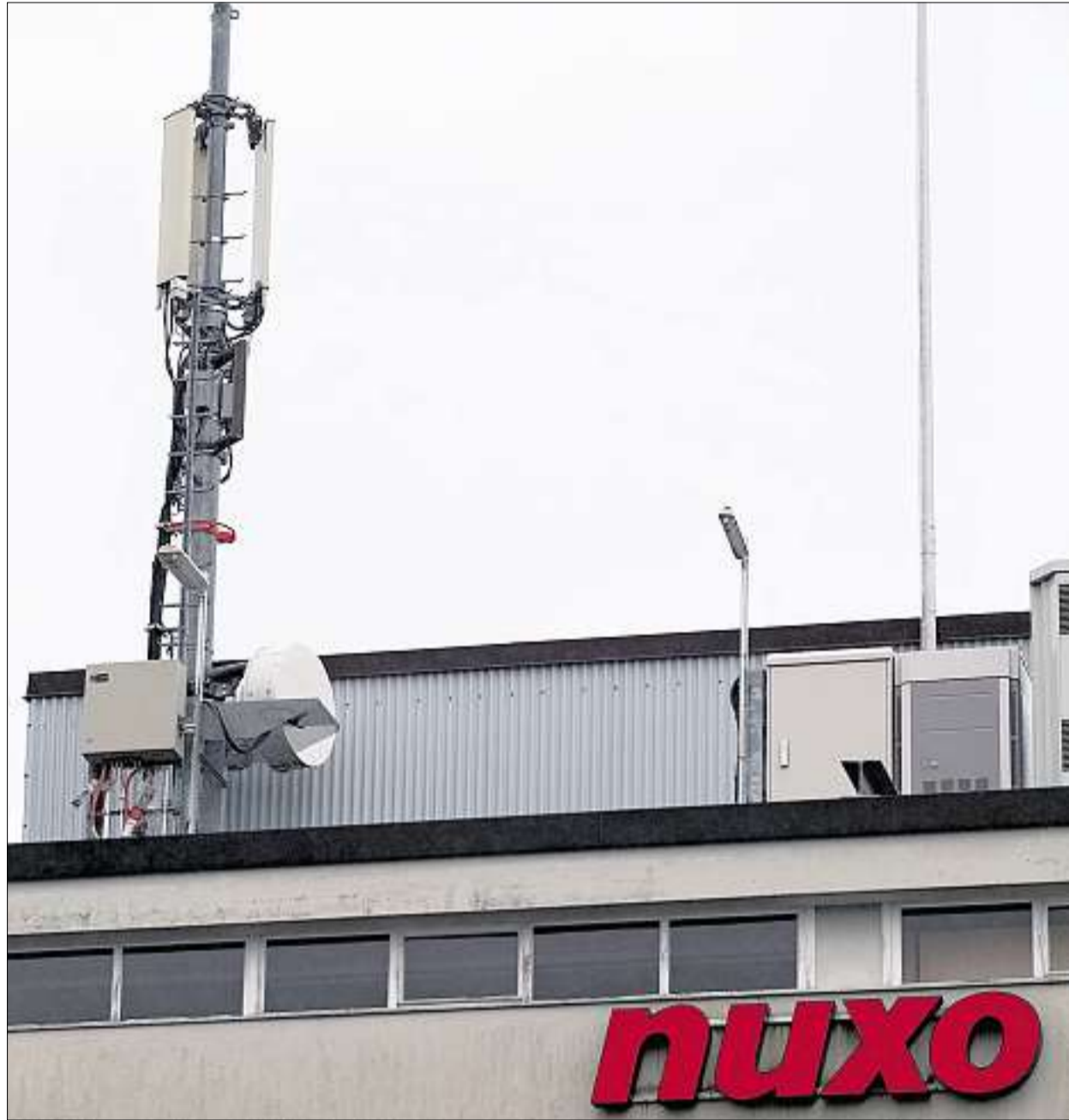
Nachdem das Bauverbot von Mobilfunkanlagen aufgehoben worden ist, rückt nun die Verlegung der Antenne vom Dach des Industriegebäudes Nuxo ins Wohngebiet wieder in greifbare Nähe. (Manuela Matt)
